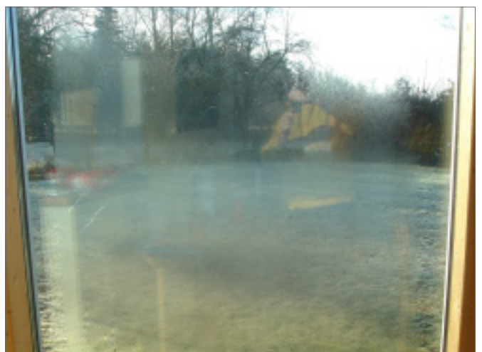
13. 1. 2008, 11:53 Uhr: Kurz vor Mittag ergibt sich eine beinahe vollständige Durchsicht. Nur noch ein dünner Tauwasserfilm ist auf der Außenoberfläche zu verzeichnen, der eine halbe Stunde später schon nicht mehr vorhanden sein wird.
