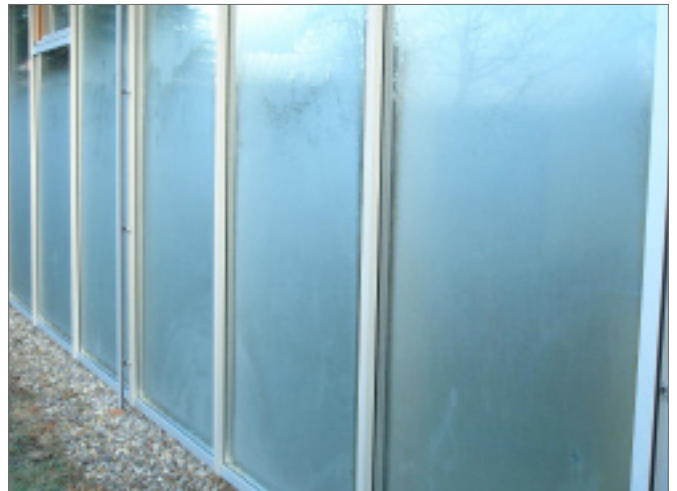
13. 1. 2008, 09:33 Uhr: Die Außenfläche der Verglasung ist nahezu komplett zugefroren. Hier die Außenansicht der Pfosten-Riegel-Fassade.
