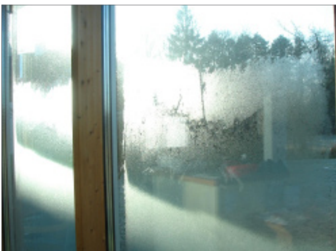
13. 1. 2008, 11:09 Uhr: Die Sonne steht bereits im Südosten. Die Sonnenstrahlung trifft auf die Glasfassade und erwärmt sofort die ersten Bereiche im oberen Drittel, die bereits abtauen und die Sicht nach außen allmählich ermöglichen.
